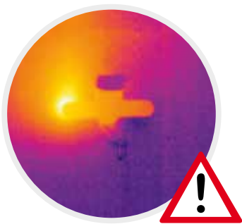
Mengkraan aangesloten via dubbele wandplaten. (Temperatuur in de warm water muurplaat > 25^{\circ}\text{C} )
